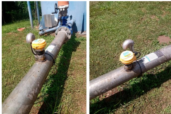
Figura 1: Exemplo da instalação de um medidor de vazão de inserção rotor magnético.
