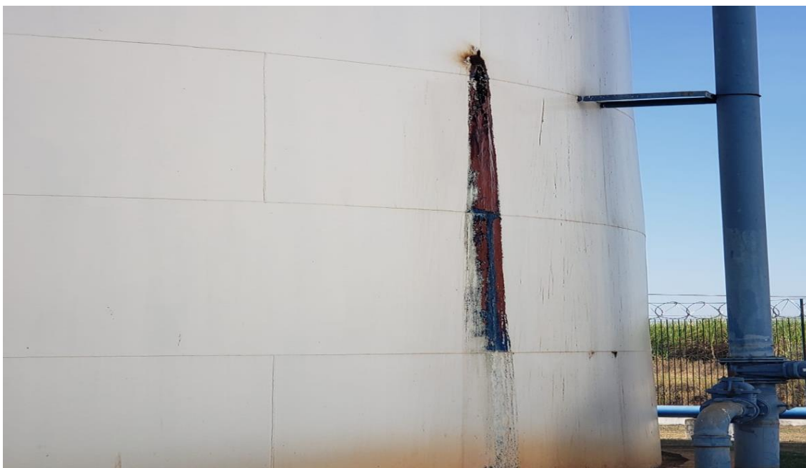
Figura 1: Local do vazamento constatado no reservatório da UC3 – Boa Vista.
