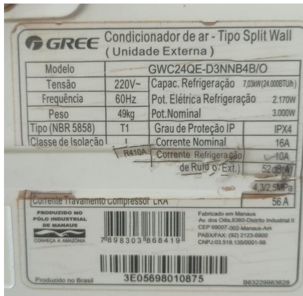
Figura 1: Dados de placa da condensadora com motor a ser substituído.
