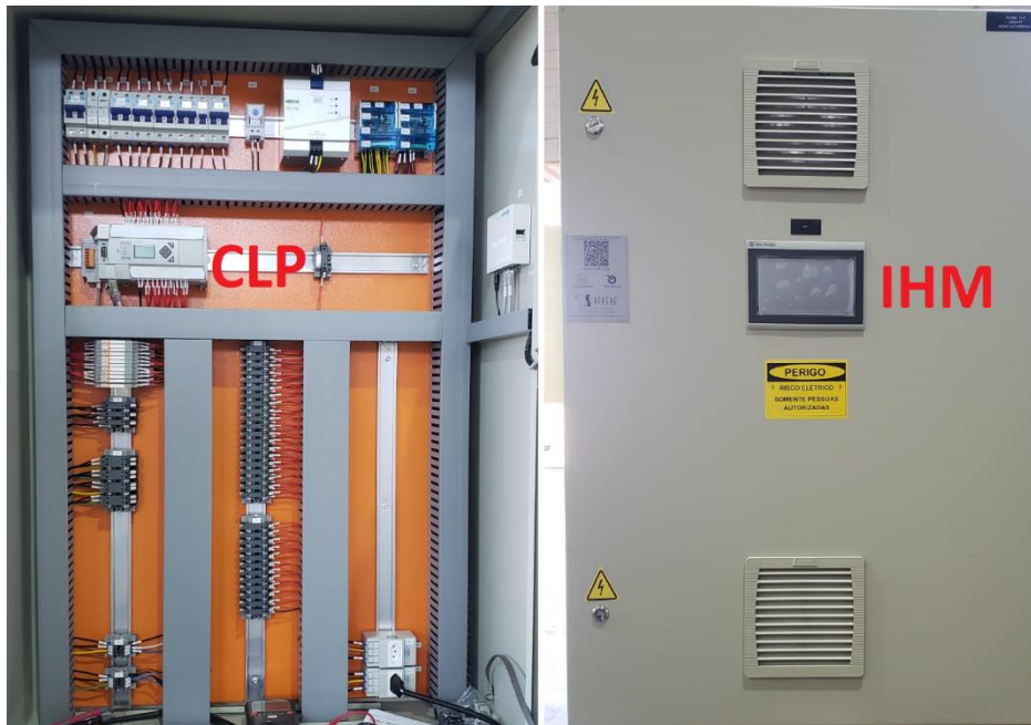
Figura 1: Exemplo da instalação de um CLP e IHM em um painel da SAEC.
