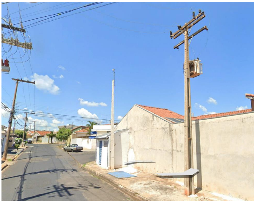
Figura 1: Transformador a ser substituído.
