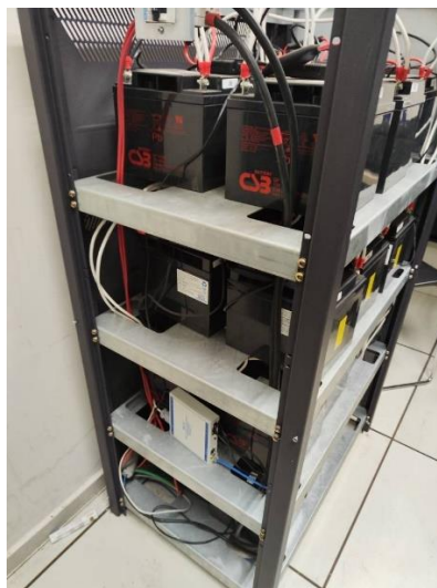
Figura 2- Banco de baterias.
