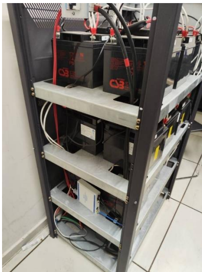
Figura 2- Banco de baterias.
